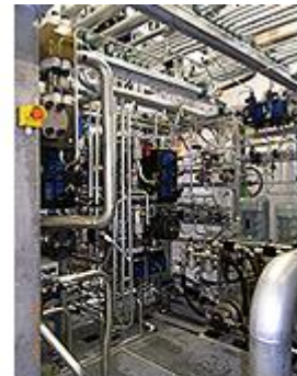
Abb.: Hydraulikaggregat eines Prüfstands für Steuerblöcke mit 8 Druckkreisen und 350kW Antriebsleistung
